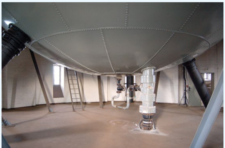
Bild 30. Behälter im neuen Westend-Turm. ▼
